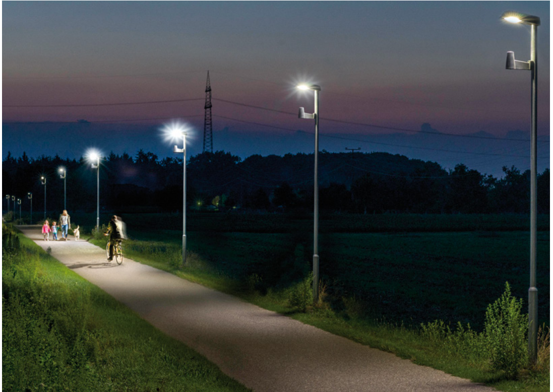
Abb. 4.1: Bedarfsgerechte Beleuchtung durch integrierte Bewegungsmelder (Foto: Netze BW GmbH)
